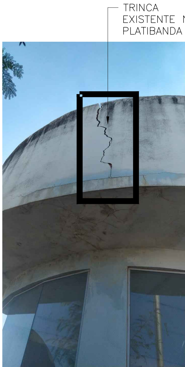
7 FOTO 2 - TRINCA NA PLATIBANDA S/ESCALA
